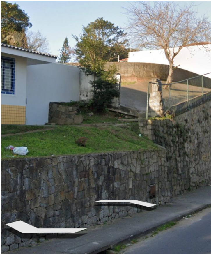
Foto 3 – Muro quebrado na parte de baixo do terreno
